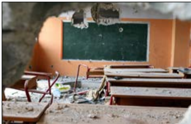
Ecole détruite au Nord du Mali.
