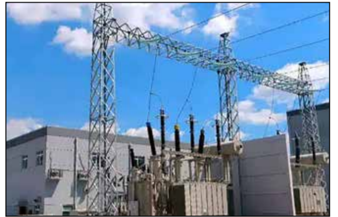
Le poste transformateur de Kinsuka
