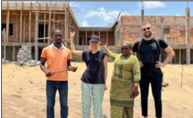
Sr Ida Pélagie Louvouandou et les partenaires internationaux devant le bâtiment en construction de l'Îlot de Boboto.
